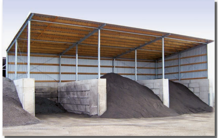
Pultdachhalle Typ PD2 (2-seitig geschlossen) genutzt als Schüttgutlager
